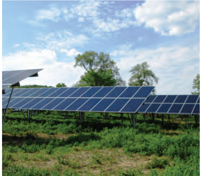
Photo: Solar Array Wikimedia Commons 32
